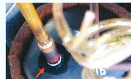
油漏れやしみて漏えいを確認
