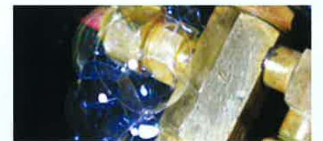
発泡剤で漏えいを確認
