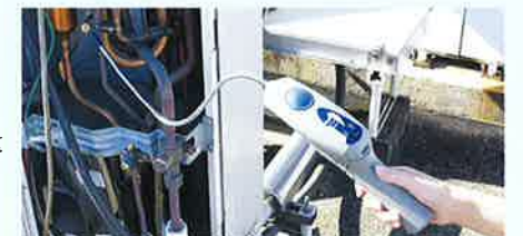
電子式漏えいガス検知器で漏えいを確認
